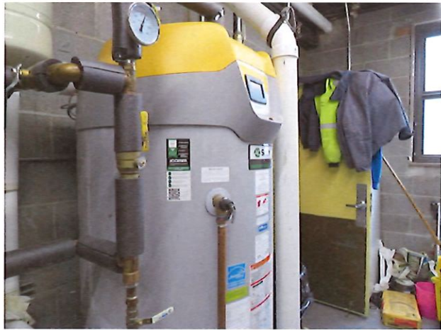
57. AO Smith Water Heater
